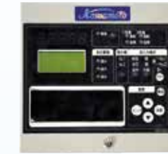
遠方監視装置 ②制御盤の設定値の変更はできません。
